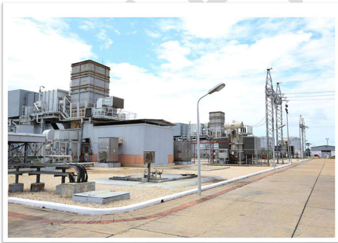
Figura 2 - Central Termoeléctrica do Malembo, Cabinda
